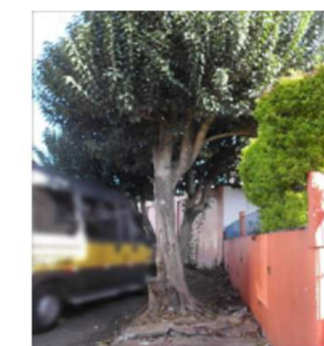
INTERRUPÇÃO DO PASSEIO/ RAÍZES EXPOSTAS
